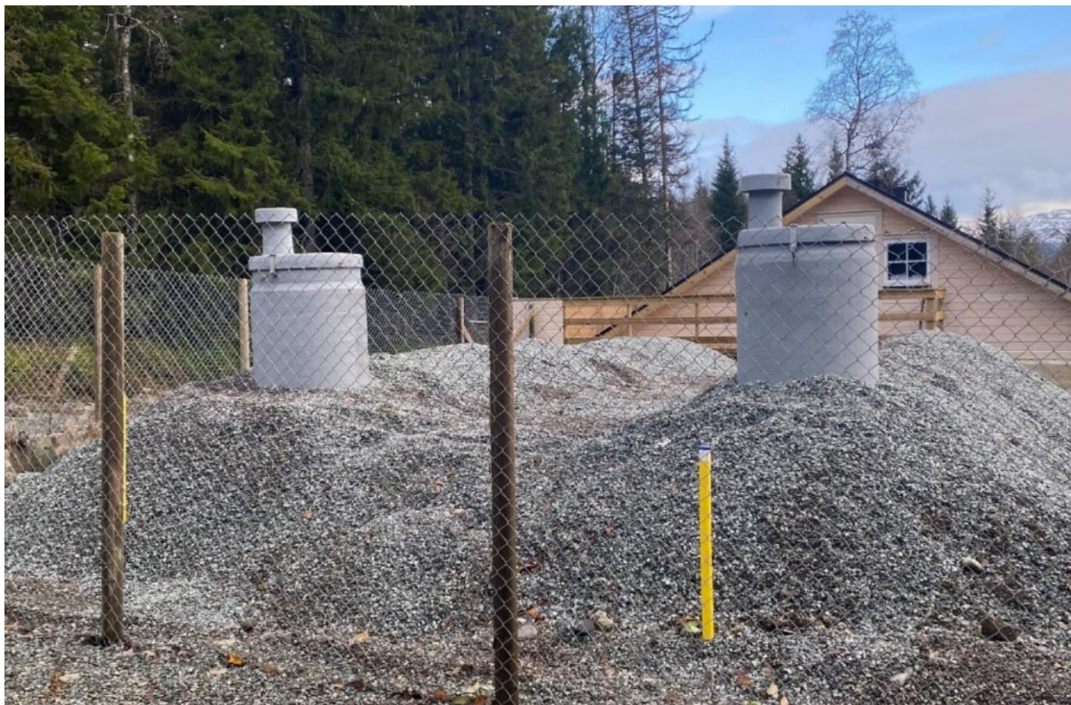
Figur 11: Bilde av de to nedgravde GUP-tankene som viser at de er sikret med hengelås og gjerder. Kapasitet på til sammen 150 m 3 . Drikkevannsbasseng sees i bakgrunnen. (Foto: Høylandet kommune)
